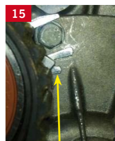
nacięcie na płycie wspornikowej
