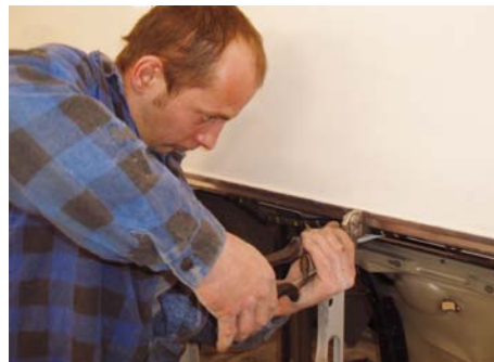
DLA POŁĄCZENIA Z NOWYM ELEMENTEM KONIECZNE JEST WYKONANIE ODSADZKI NA KRAWĘDZI POZOSTAŁEJ CZĘŚCI POSZYCIA
