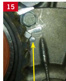
nacięcie na płycie wspornikowej
